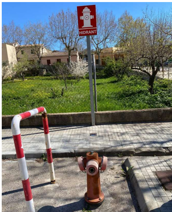
Figura 37. Hidrante de columna señalizado en el núcleo urbano de Puigpunyent. Fuente: Ayuntamiento de Puigpunyent
