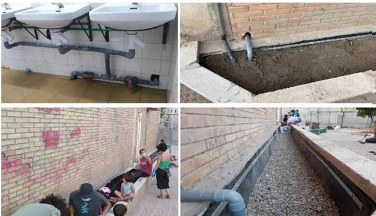
Obras de depuración de aguas grises en el CEIP Mar Mediterráneo de Almería
