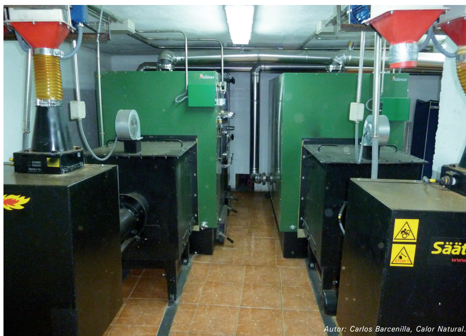
Calderas de biomasa instaladas en sustitución de antiguas calderas a base de combustibles fósiles en una comunidad de vecinos de la ciudad de Palencia.
