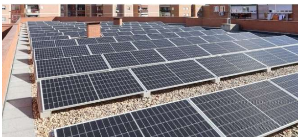
Fig. 14 Placas solares fotovoltaicas en el Centro de Tercera Edad 'Ramón Rubial' Fuente: Que Madrid
