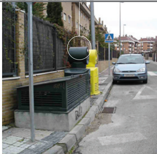
aceras ocupadas e interrumpidas
