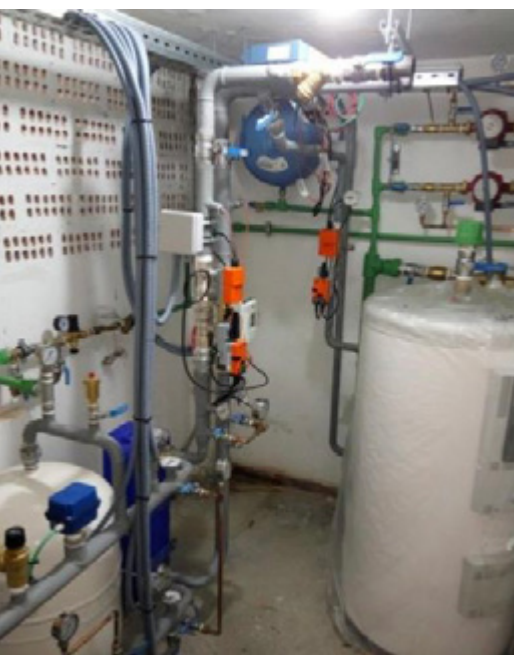
Arriba: central de producción. Abajo: subestación en cada portal.
