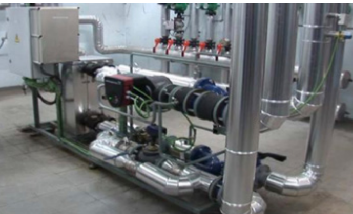
Subestación de un edificio.
